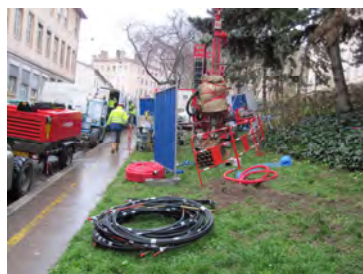
Occupation de l'espace vert rue Magneval qui sera remis en l'état après les travaux
